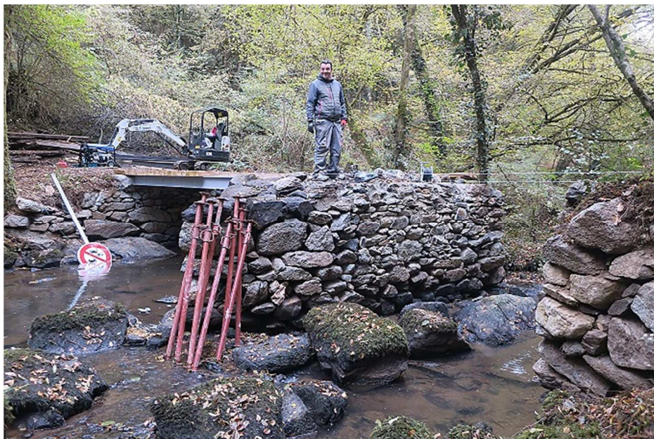
Reconstitution de la chaussée (cliché du 29 octobre 2018)
