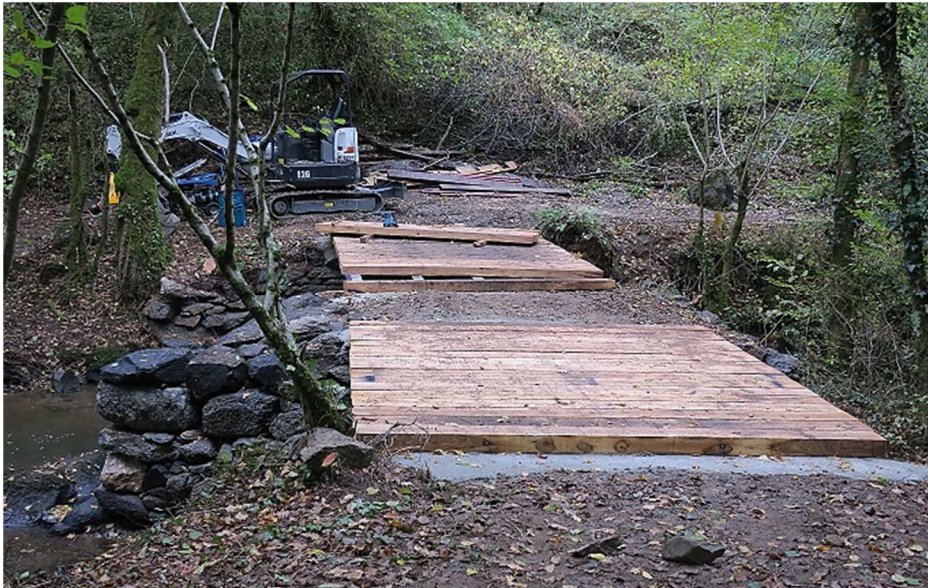
Reconstitution de la chaussée (cliché du 31 octobre 2018)
